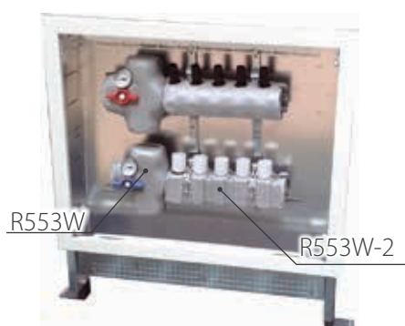
Рисунок 19. Установленный в шкаф коллектор с теплоизолирующими оболочками.
